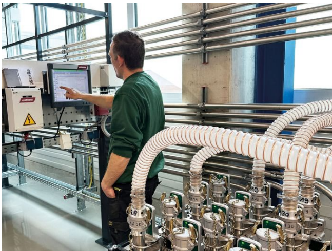
Die M8 Steuerung der zentralen Materialversorgungsanlage wurde von den Mitarbeiterinnen und Mitarbeitern sehr gut angenommen.
