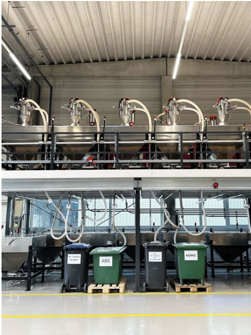
Die Trocknerbühne überschaat das Materiallager. Direkt unter der Bühne ist Platz für die Behälter der am häufigsten eingesetzten Materialien.
