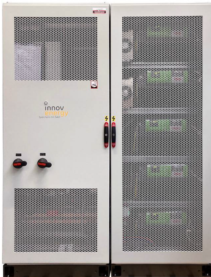
Abb. 3: Solarstromspeicher bestehend aus modernster ökologischer Salzbatte-rientechnik der Firma innovenergy®
