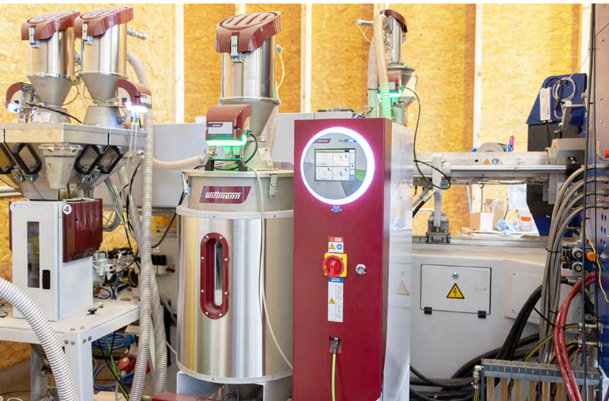
Bei ANA-U installierte Dosier-, Förder- und Trockentechnik aus dem Hause WITTMANN.
