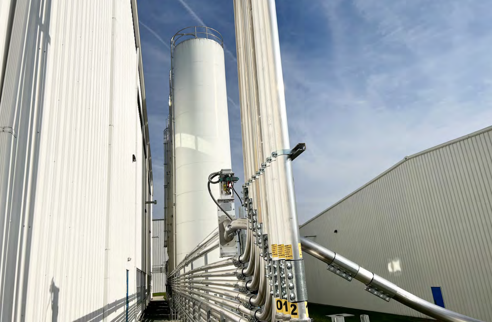
WITTMANN diseñó e instaló sistemas de manejo de materiales, incluyendo tuberías y silos, que transportan materiales reprocessados a silos y edificios designados en Monflo.
