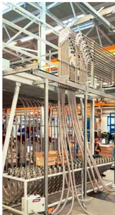
Dos vistas de la tubería del sistema de transporte de material de WAREMA PT.
