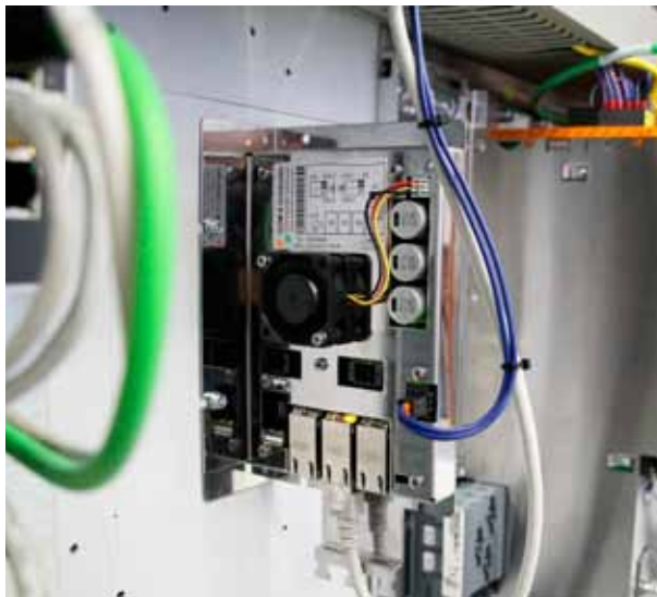
Vista del enrutador instalando en el gabinete de control de la máquina de moldeo por inyección.
