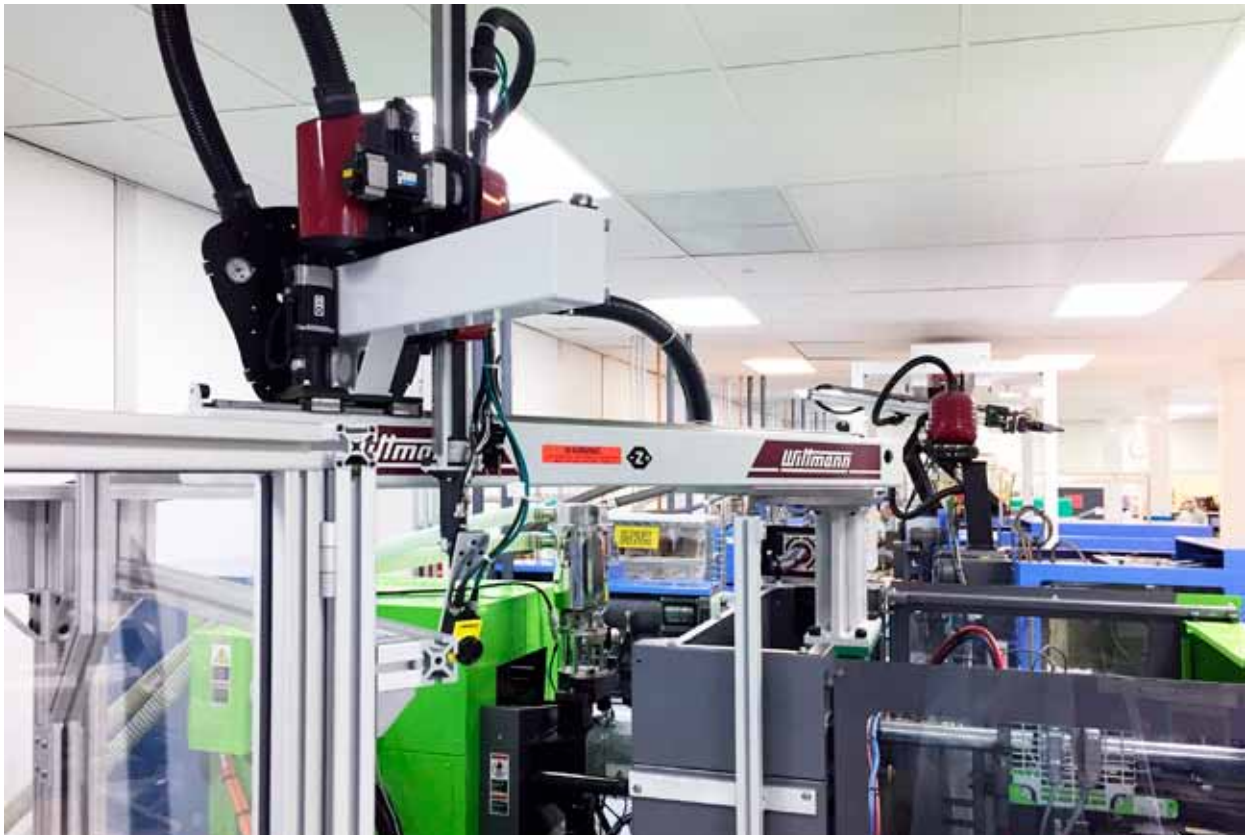
Vista del sistema de automatización de RenyMed: robots WITTMANN trabajando en las máquinas de moldeo por inyección de RenyMed en su planta en Baldwin Park, California, EE.UU.
