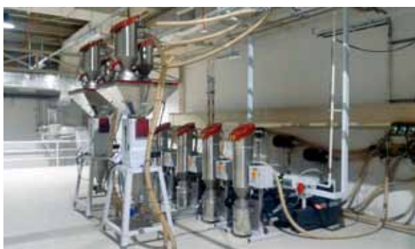
Mezcladores GRAVIMAX en pedestales, justo atrás de las estaciones de filtrado y bombas de vacío.
