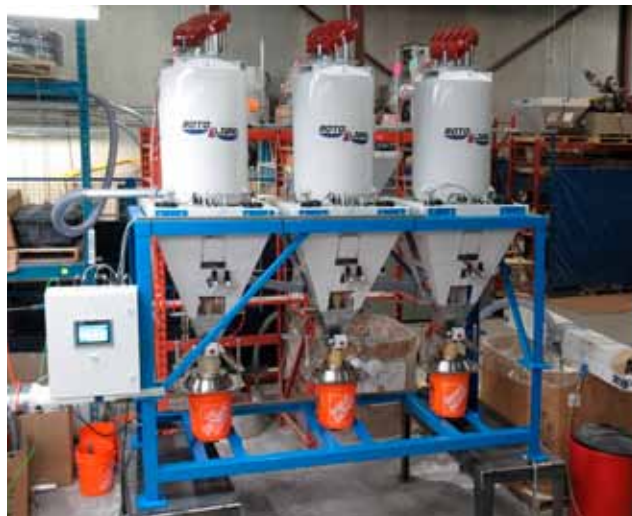
Vistas de las instalaciones ROTOLOAD.
