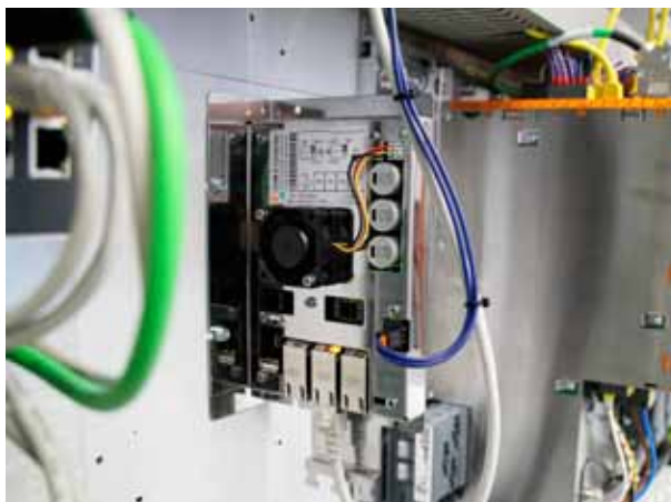
Ansicht des im Schaltschrank der Spritzgießmaschine eingebauten Routers.
