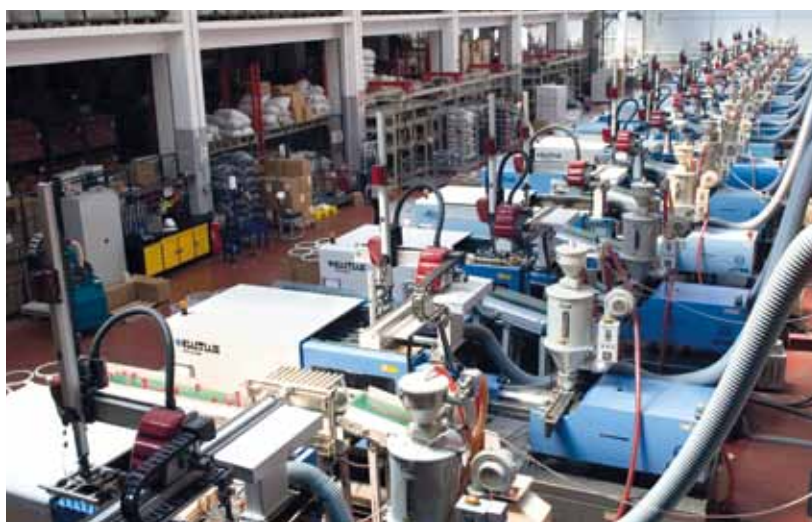
Die Produktionshalle von STAR PLASTIK in Istanbul. Sämtliche Verarbeitungsmaschinen sind mit Automatisierungslösungen von WITTMANN ausgestattet.
