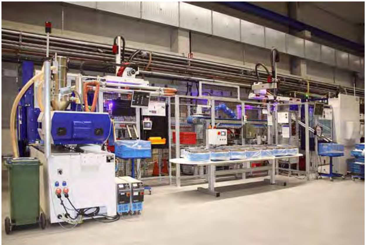
Gesamtansicht der über ein staufähiges Fördersystem verketteten EcoPower 110/350 Spritzgießmaschinen von WITTMANN BATTENFELD.
